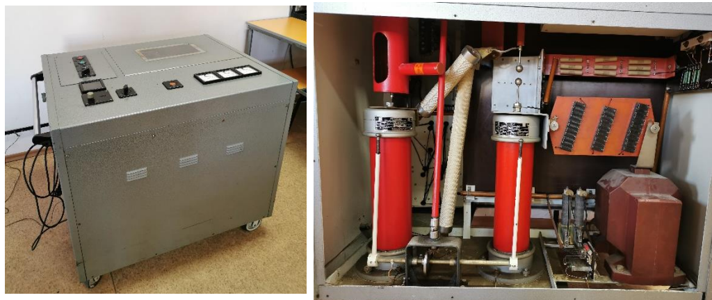
Fig. 4 – Generatorul de impuls de tensiune monoetaj de 30 kV din dotarea laboratorului: vedere de ansamblu, respectiv în detaliu din interiorul acestuia
